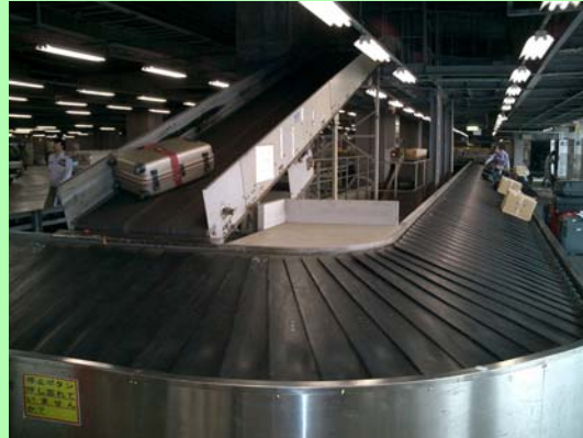
手荷物搬送設備(BHS)
