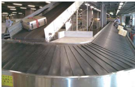
手荷物搬送設備
