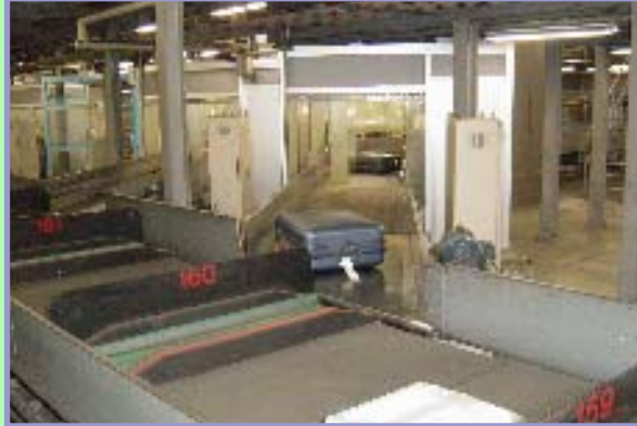
手荷物搬送設備 (BHS)
