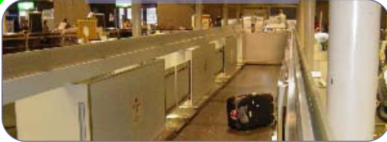
手荷物搬送設備: BHS
