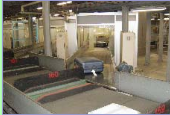
手荷物搬送設備 (BHS)
