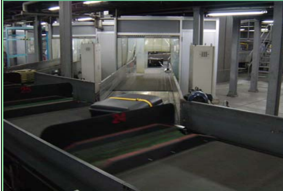
手荷物搬送設備 (BHS)
