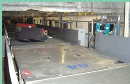
● 手荷物搬送設備
