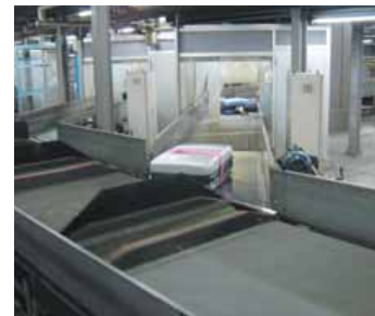
手荷物搬送設備
