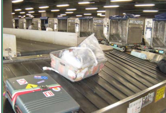
手荷物搬送設備 (BHS)
