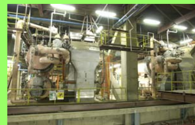
冷熱源供給設備
