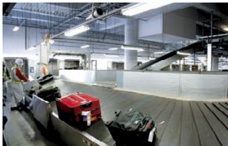
手荷物搬送設備
